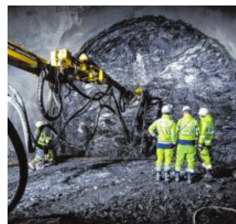
25,2 Kilometer Haupttunnel werden zwischen Pfnos und dem Brenner gegraben. Foto: BBT SE
